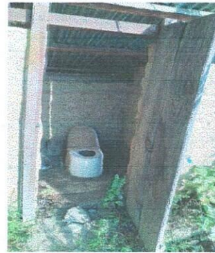
Foto 2: Deterioro del servicio sanitario
