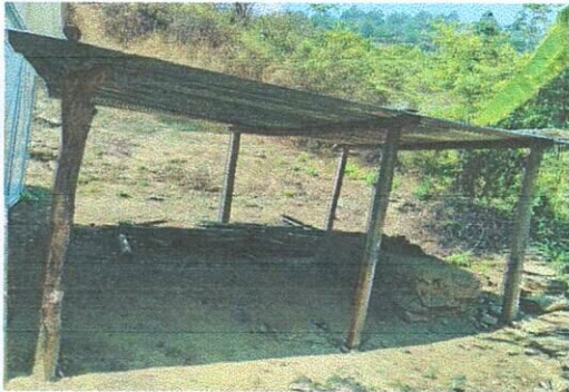
Foto 3: Cocina en mal estado
